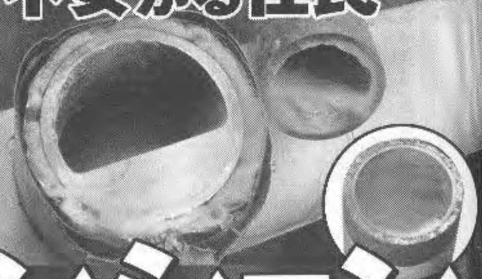
垂れ下がった給水管。円形の内側には正常な施工例 樹脂が垂れ下がった給水管。円形の内側には正常な施工例
