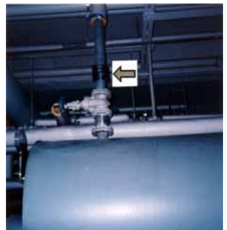
ストレージタンク二次側
