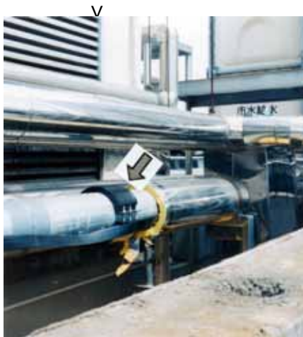
高架水槽二次側
