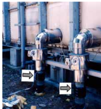
受水槽二次側
