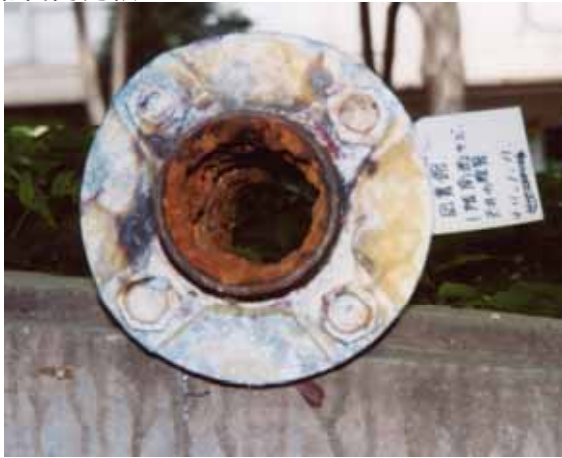
NMRパイプテクター未設置配管 (平成11年1月13日脱管)
