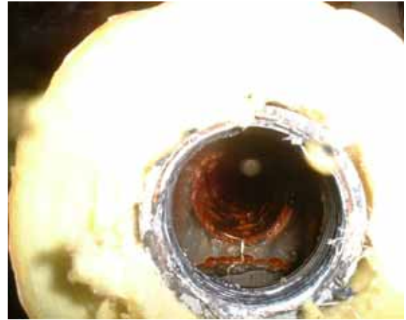
NMRパイプテクター設置配管 (平成12年8月8日脱管)
