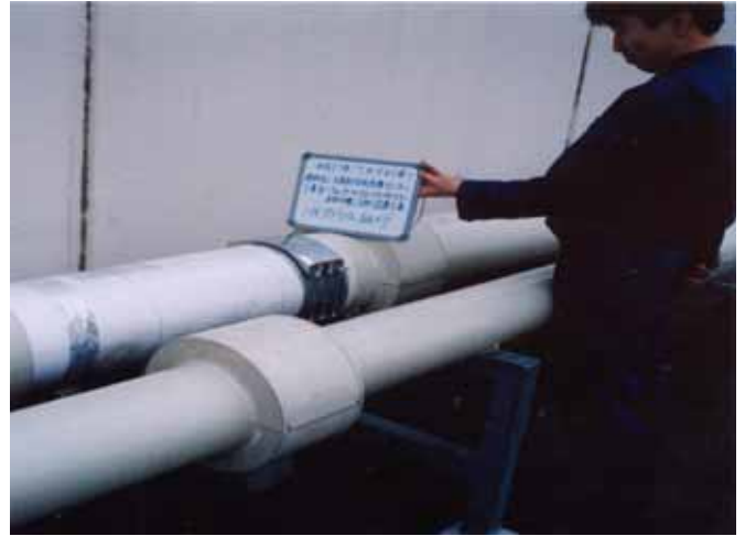
高架水槽二次側 PT - 200DS
