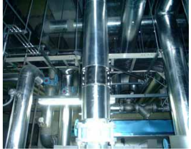
温水ポンプ2次側配管 PT - 125DS
