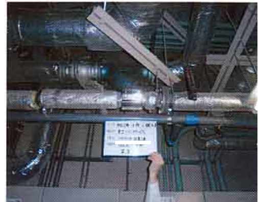
加圧ポンプ二次側給水配管(低層階用 B4F - 3F ) PT-75DS 1セット
