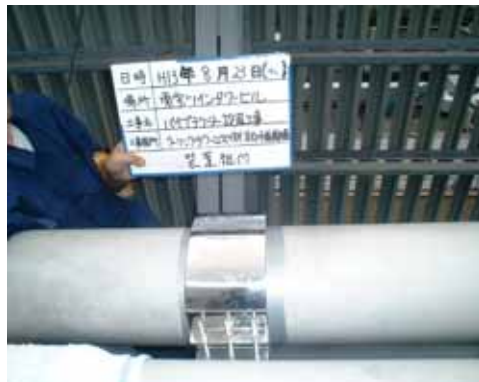
クーリングタワー二次側冷却水配管 PT-200DS 1セット
