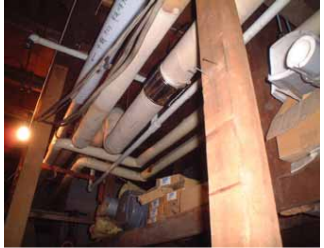
ボイラー二次側 PT - 75DS
