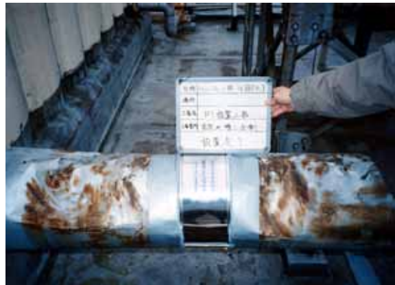
高架水槽二次側 PT - 200DS
