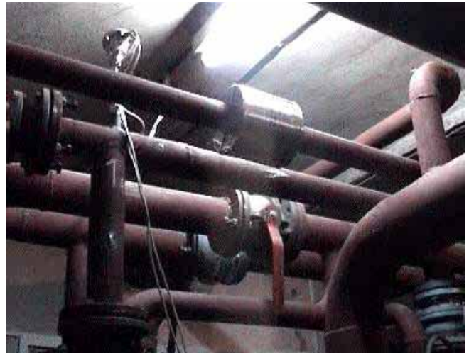
地下給湯ポンプ室温水系統配管 PT - 50DS
