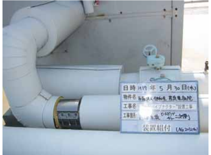
ヒートポンプチラー二次側 PT - 100DS
