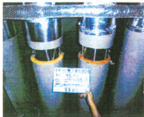
冷温水発生器 二次側冷温水配管に取り付けられた直後のNMRパイププレクター
